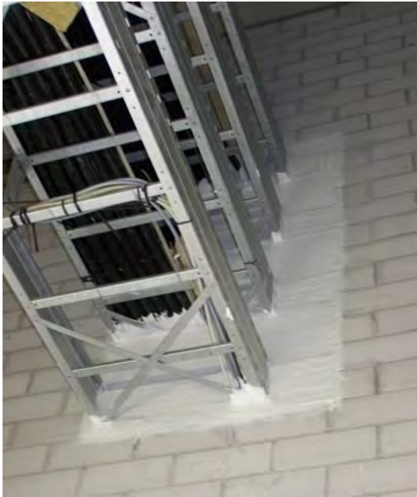
G4 sz. ábra. Villamos vezetékek tűzgátló lezárása szakszerűen kivitelezett lágyzárással (kétoldalt tűzvédelmi bevonattal ellátott közetgyapottal)
