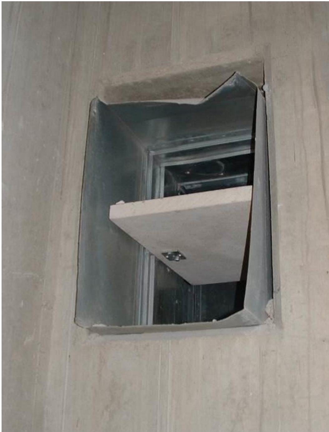
G3 sz. ábra. Tűzgátló csappantyú, amelynek sérülése a csappantyúnyelv beszorulását okozhatja; a csappantyúház és a fogadószerkezet közötti tűzgátló réskitöltő-réslezáró rendszer is hiányzik
